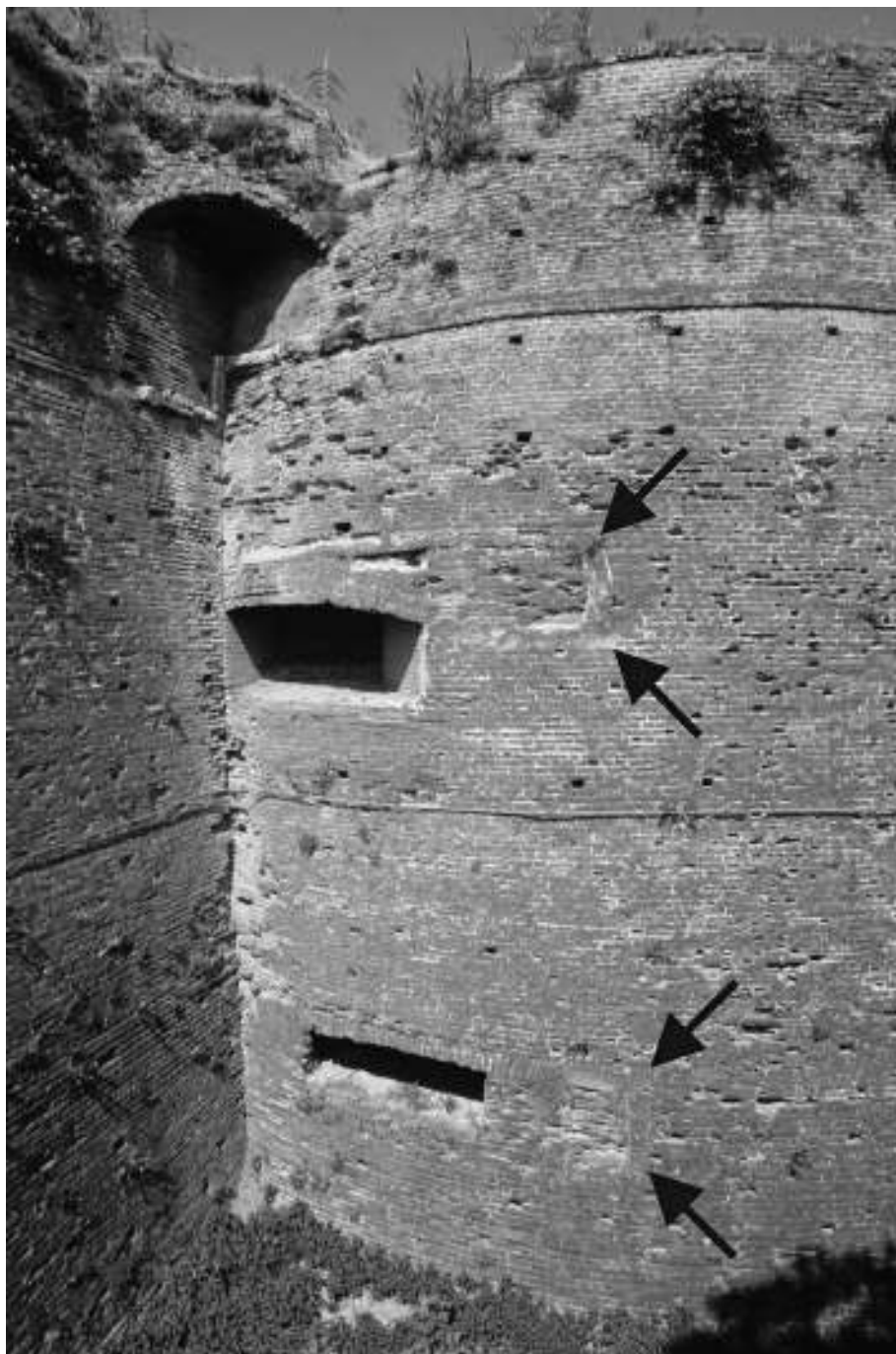
Fig. 17 - Nel torrione sud-ovest è immediatamente percepibile la sostituzione delle cannoniere C, i cui bordi esterni sono evidenziati dalle frecce nere, con quelle successive, coperte ad arco ribassato o piattabanda in laterizio.
